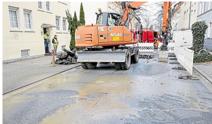
Wegen eines Wasserrohrbruchs ist ein Abschnitt der Schützenstraße vorerst gesperrt. Fotos: Jörn Martens
